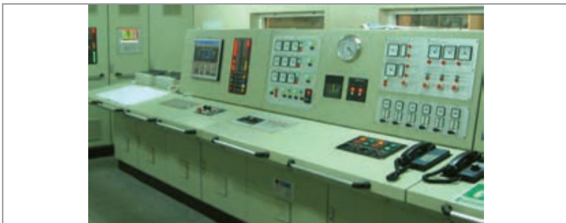
شکل ۴۰ - سامانه هشدار اتاق کنترل موتورخانه
