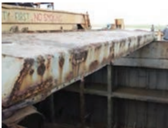
شکل ۲- در انبار که دچار خوردگی شدید شده است.
